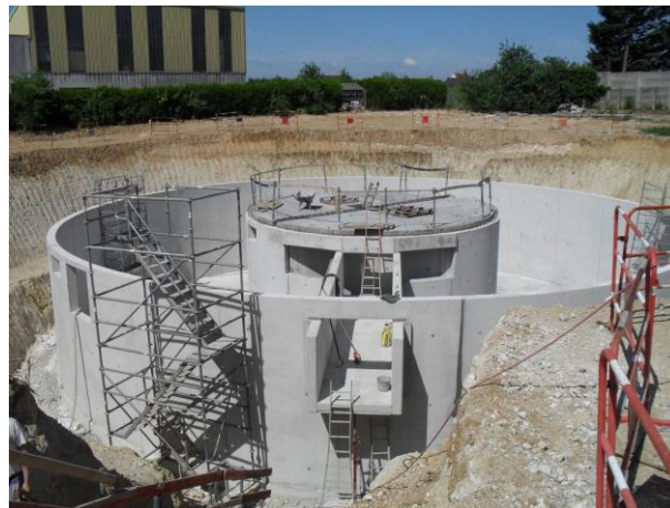
Bassin de rétention en béton armé
