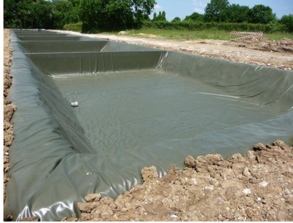
Bassin de rétention avec étanchéité par géomembrane
